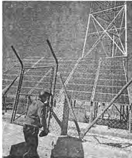
ۋىنەى ۹ - ۴۴: دانانى سىستەمى فۆتوفۆلتايكى لە ۋىستگەپەكى گەياندن (تېلىكۆم)
